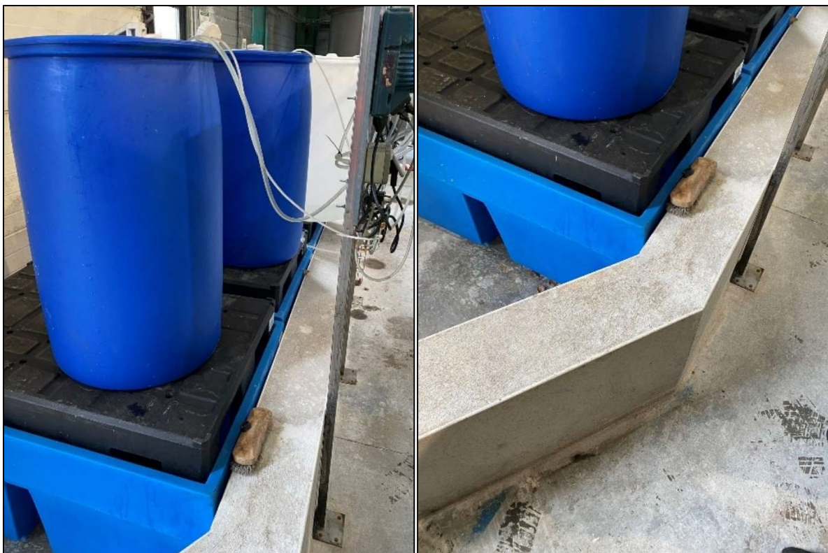
Figure 49. Photographies des rétentions (à gauche : acide et soude ; à droite : muret de rétention)
