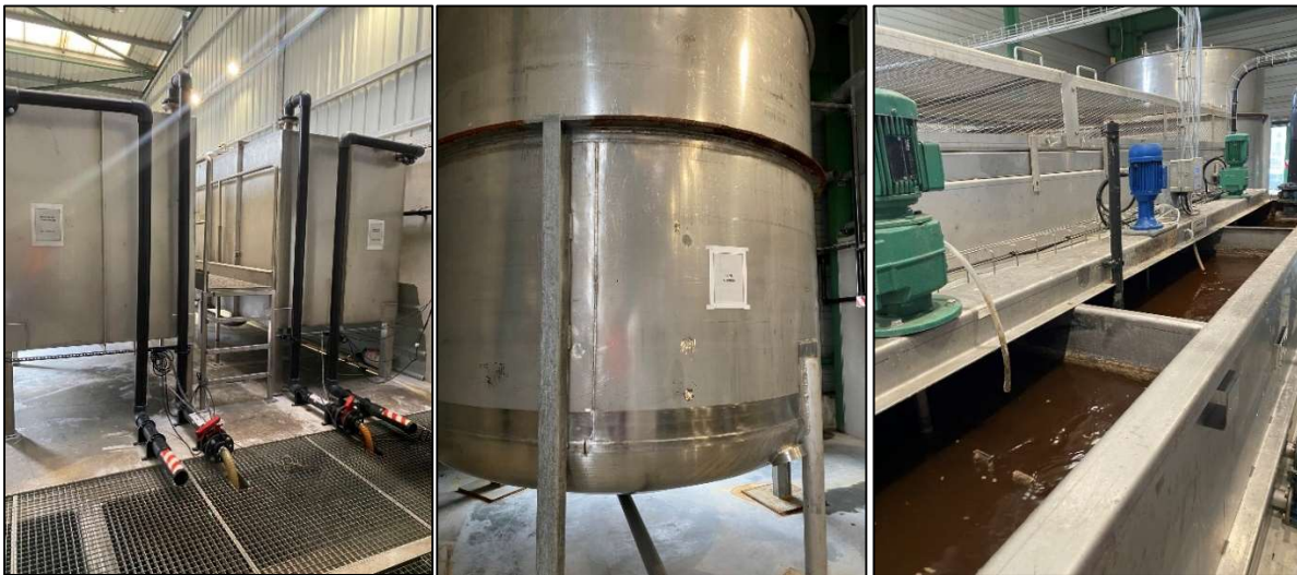
Figure 45. Photographies de la station de traitement des eaux (à gauche : les bacs déshuileur-déboureur ; au centre : cuve à boues ; à droite : contrôle pH)
